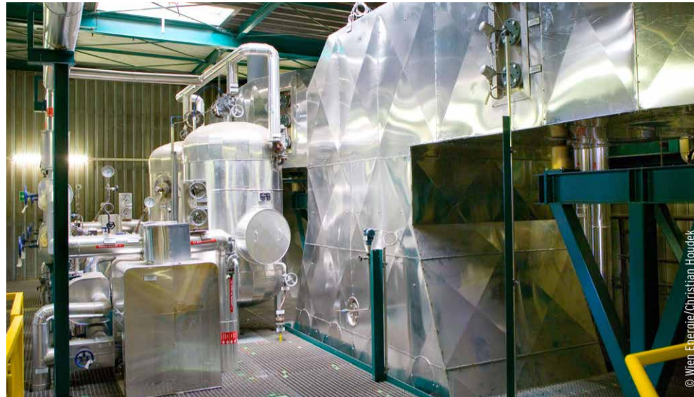
Von hier kommen jährlich ca. 470.000 MWh umweltfreundlicher Fernwärme.
