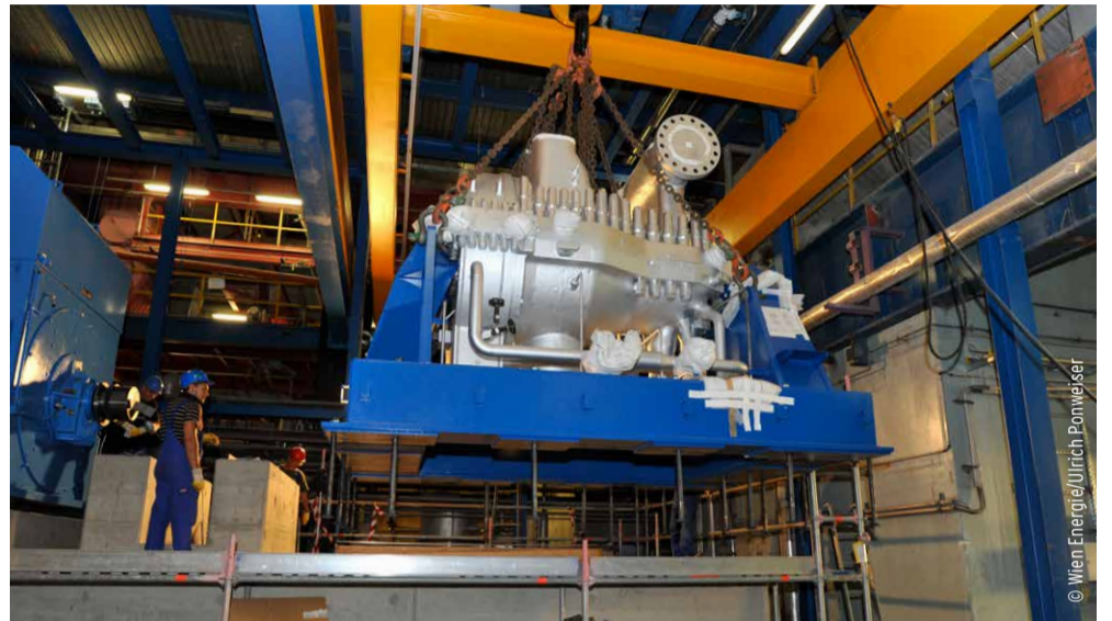
Wenn alle Rohrleitungen gründlich gereinigt sind, steht der Inbetriebnahme der leistungsstarken neuen Turbine nichts mehr im Weg.
